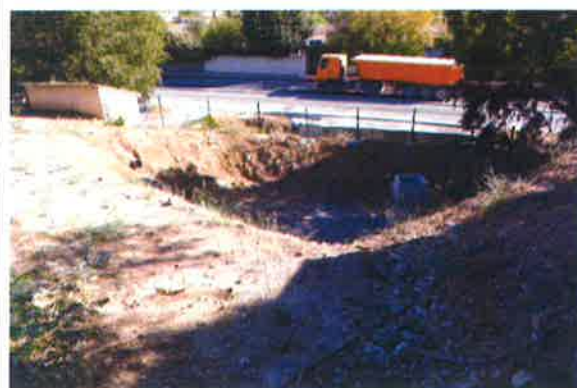
4- Bassin de rétention des eaux d'incendie
